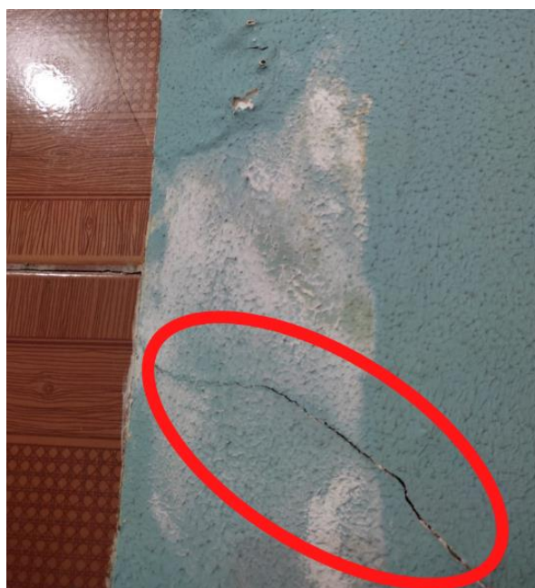
Figura 16 - Trinca em parede
