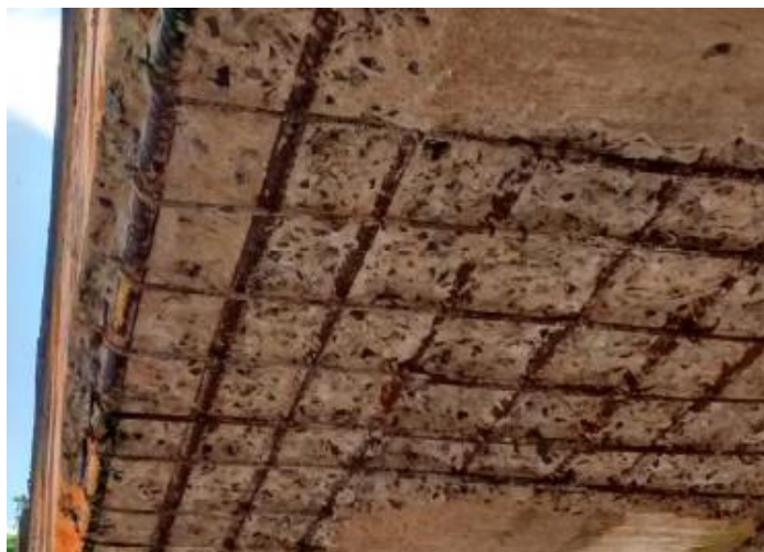
Figura 5 - Corrosão em armadura de uma laje
