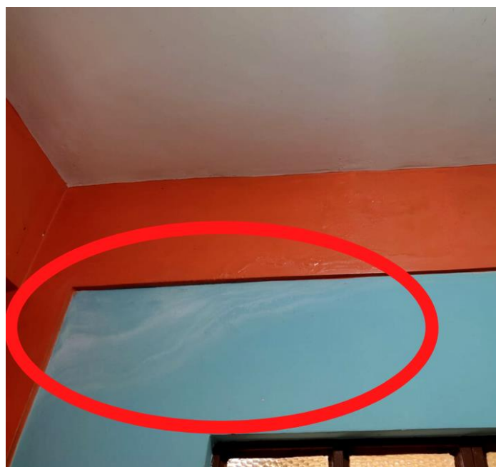
Figura 26 – Presença de eflorescência
