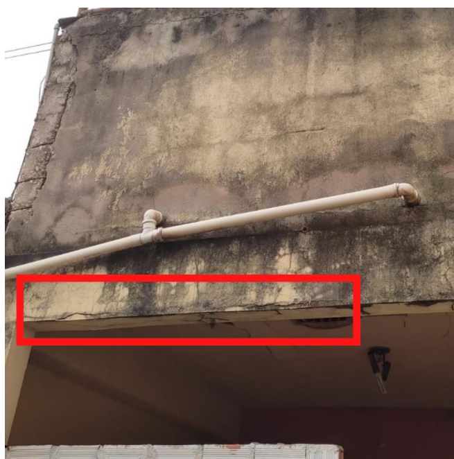
Figura 18 - Rachadura em viga da laje
