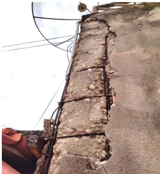
Figura 23 - Corrosão da armadura e desagregação do concreto em pilar
