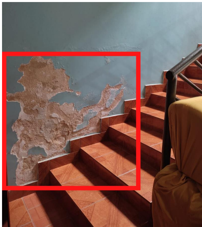
Figura 25 – Descascamento de pintura
