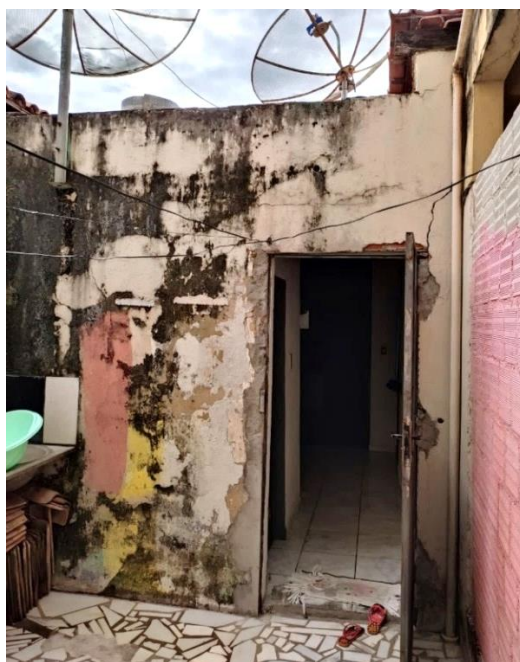
Figura 24 - Bolor em parede externa
