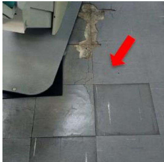
Figura 9 - Deslocamento do piso
