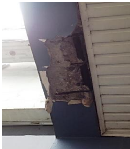
Figura 6 - Desagregação do concreto
