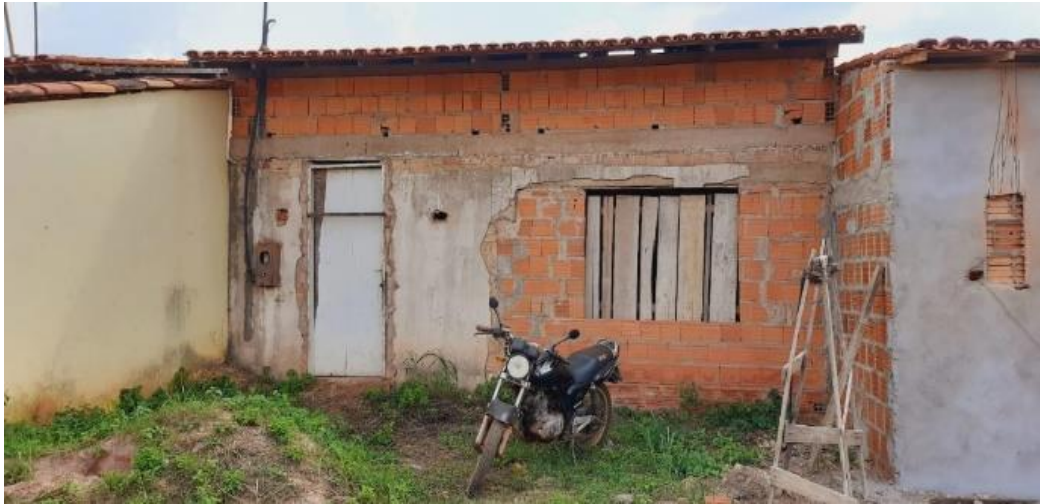
Figura 4 – Falta de alinhamento de janela e porta
