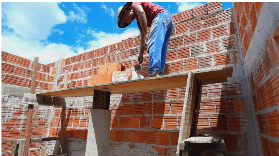
Figura 3 – Trabalho em andaime improvisado
