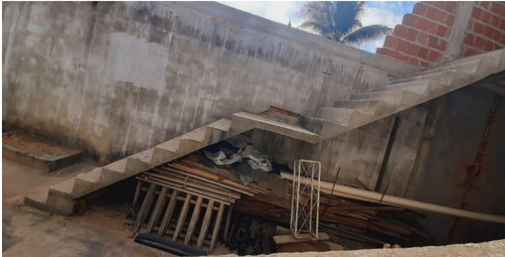
Figura 6 – Escada mal dimensionada
