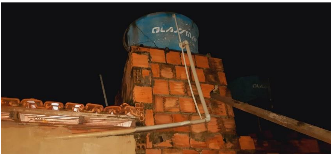
Figura 7 – Instalações hidráulicas de maneira errada
