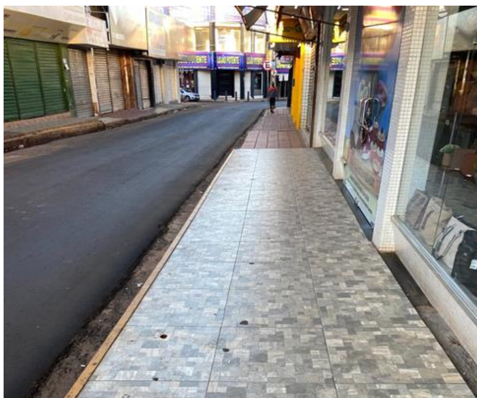
Figura 9 - Calçadas com degraus e piso escorregadio na rua Marly Sarney
