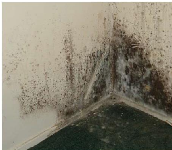
Figura 8. Ação de mofo e bolor em parede de alvenaria
