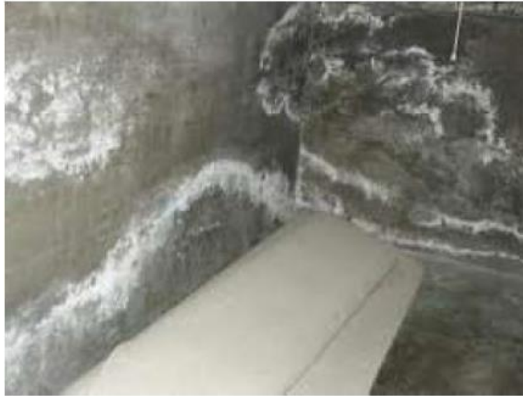
Figura 3. Formação de eflorescência
