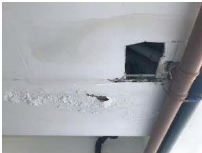
Figura 15. Umidade gerada pelo rompimento da tubulação
