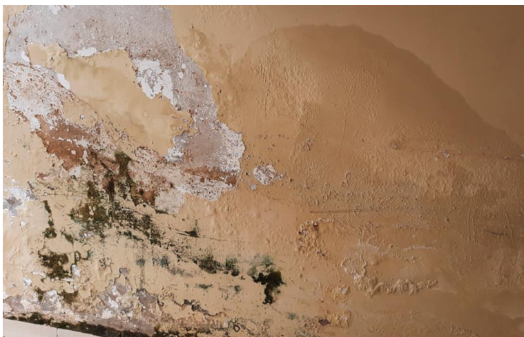
Figura 30. Descascamento da pintura
