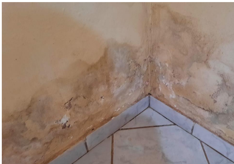
Figura 31. Umidade ascendente por capilaridade
