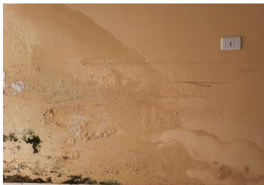
Figura 29. Umidade ocasionada pela instalação hidráulica do banheiro
