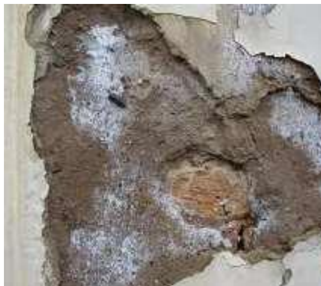
Figura 9. Ocorrência de criptoflorescências na parede da estrutura.
