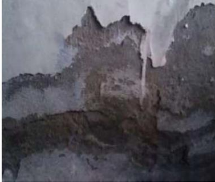
Figura 7. Desagregamento gerado no reboco da parede de alvenaria
