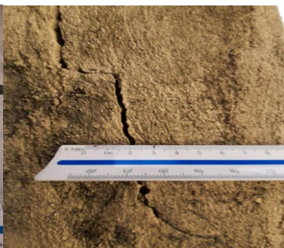
fissura interna (d)
