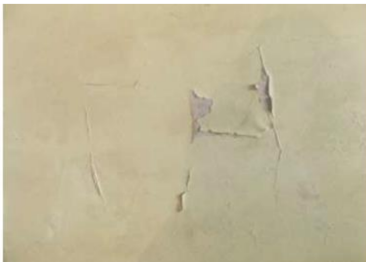
Figura 6. Descascamento de pintura na superfície de parede
