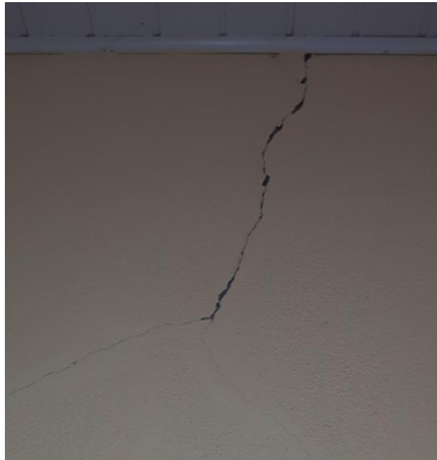
Figura 35. Fissura na parede da cozinha.
