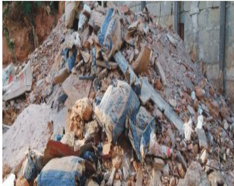
Figura 14: Parte interna com resíduos de argamassa, tijolos e restos de madeira.
