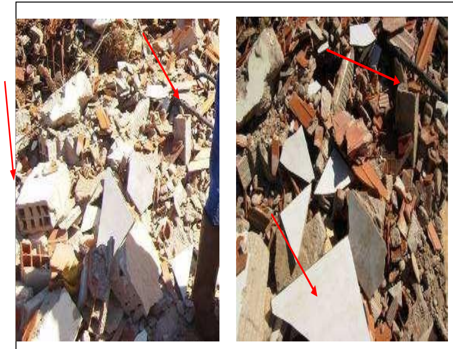
Figura 25: Resíduos de argamassa, blocos cerâmicos, eletroduto e ferragens.
