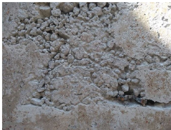
Figura 6 - Segregação no Concreto
