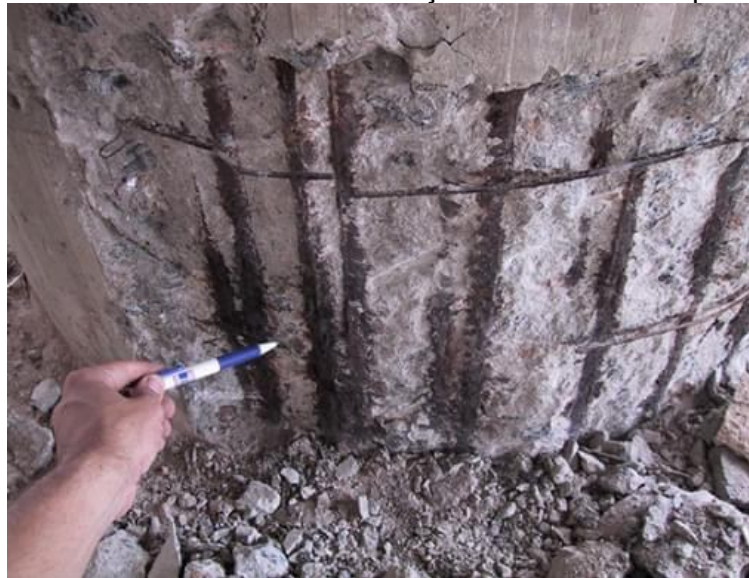
Figura 5- Concreto com corrosão avançada e armadura exposta
