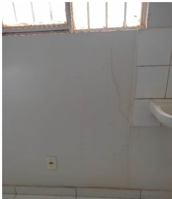
Figura 2 - Fissuras em janelas na UBS do Ouro Verde.
