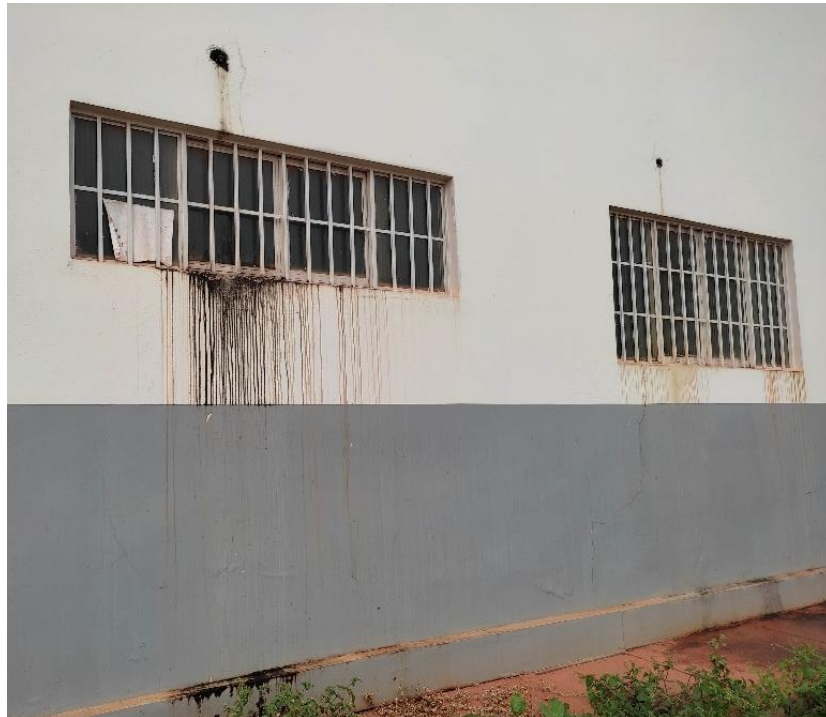
Figura 5 - Fissuras e algas nas janelas da fachada lateral da UBS do Ouro Verde.
