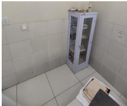
Figura 16 - Escurecimento da cerâmica da parede.
