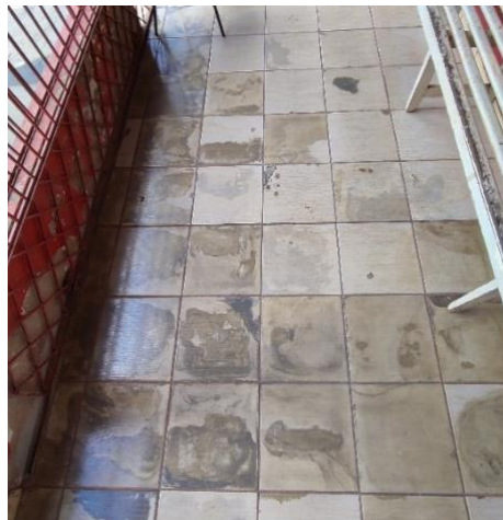
Figura 30 - Mancha no piso cerâmico.
