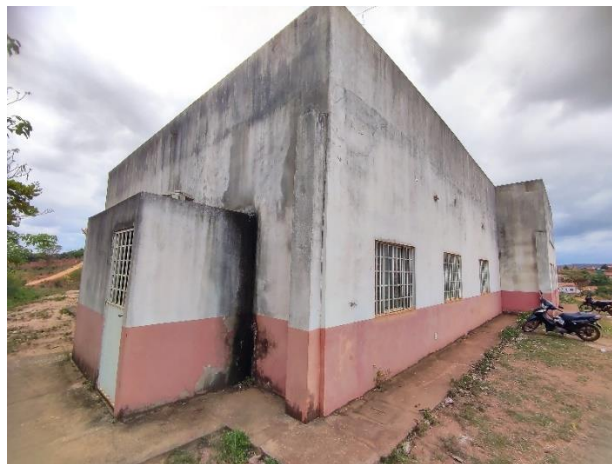
Figura 14 - Fachada com sujeira e algas.
