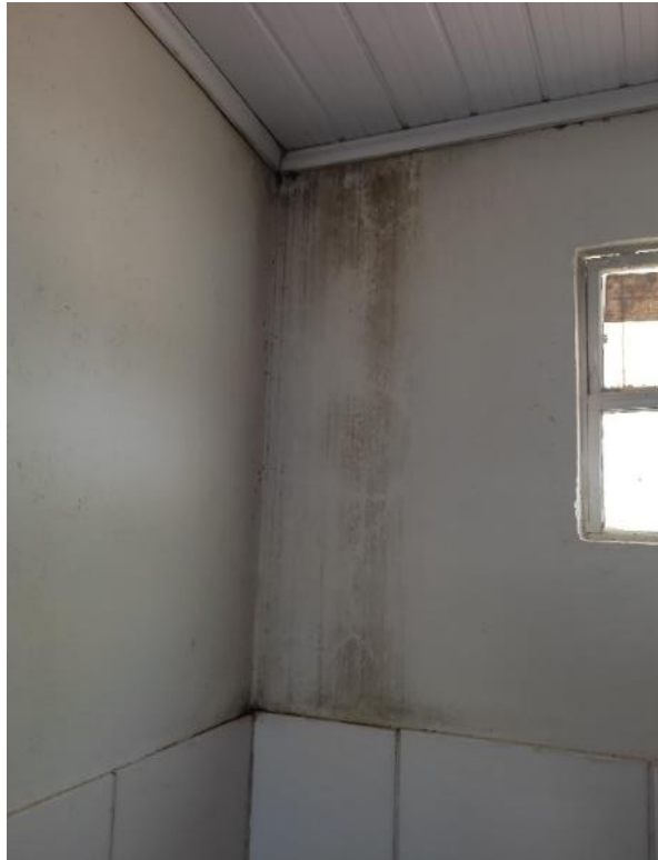
Figura 20 - Infiltração com manchas.
