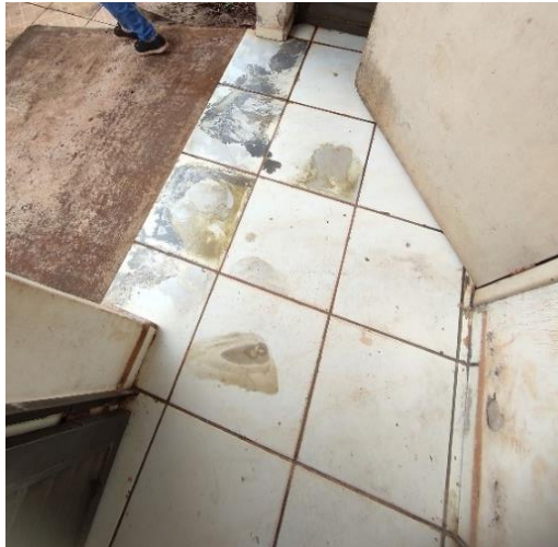
Figura 29 - Manchas escuras no piso cerâmico.
