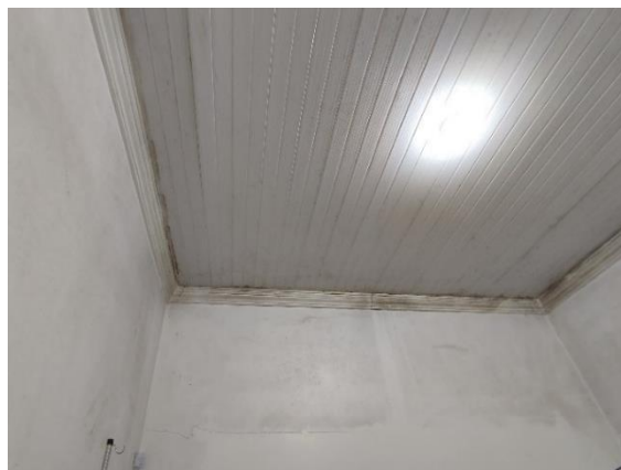
Figura 28 - Manhas escuras de mofo.
