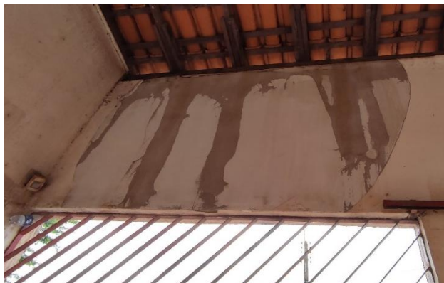
Figura 31 - Desprendimento de revestimento.
