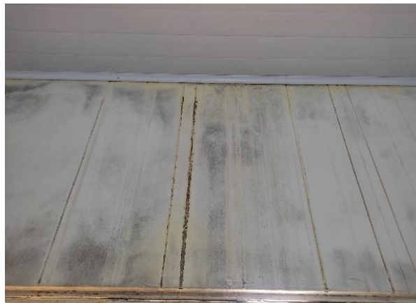
Figura 11 - Infiltração e manchas nas cerâmicas da unidade do Jardim Glória.
