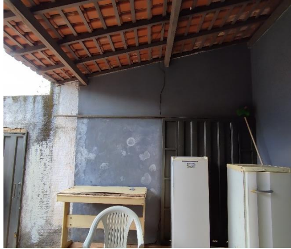
Figura 26 - Manchas devido à chuva e exposição.
