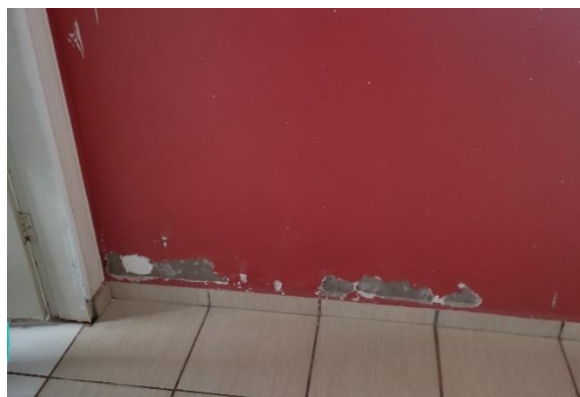
Figura 25 - Desprendimento de revestimento.
