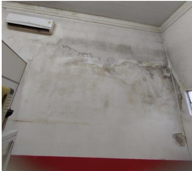
Figura 22 - Manchas de mofo; manchas e desprendimento do revestimento.
