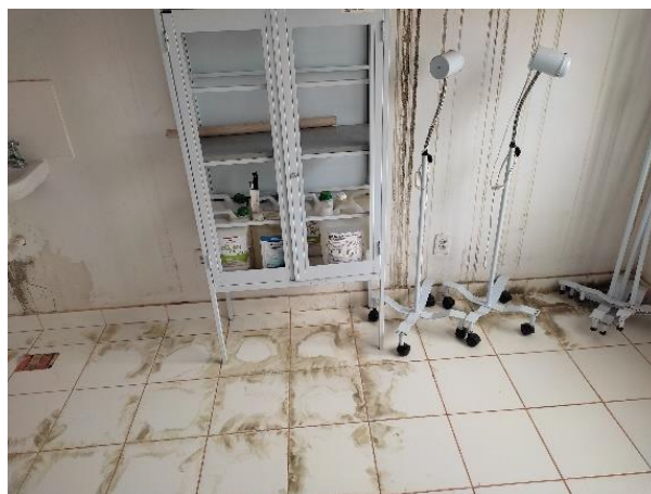
Figura 12 - Infiltração e manchas nas cerâmicas da unidade do Jardim Glória.
