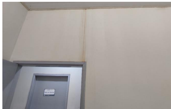
Figura 17 - Rastro de infiltração.
