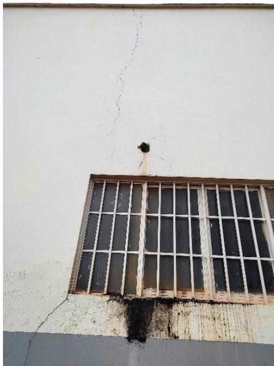
Figura 4 - Fissuras e algas nas janelas da fachada lateral da UBS do Ouro Verde.
