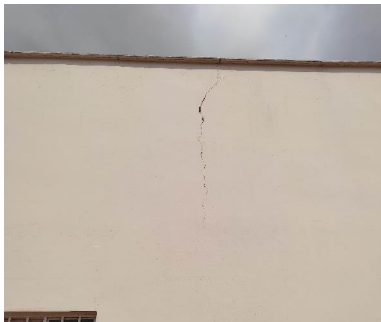
Figura 6 - Trinca na platibanda da fachada frontal da UBS do Ouro Verde.
