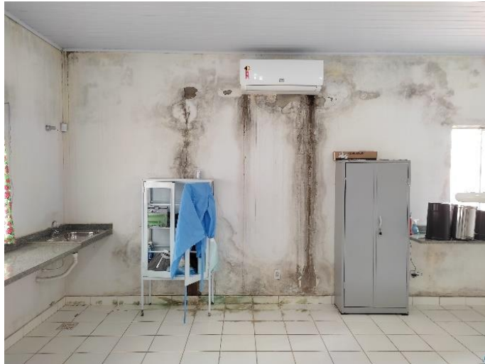
Figura 10 - Infiltração e manchas nas cerâmicas da unidade do Jardim Glória.
