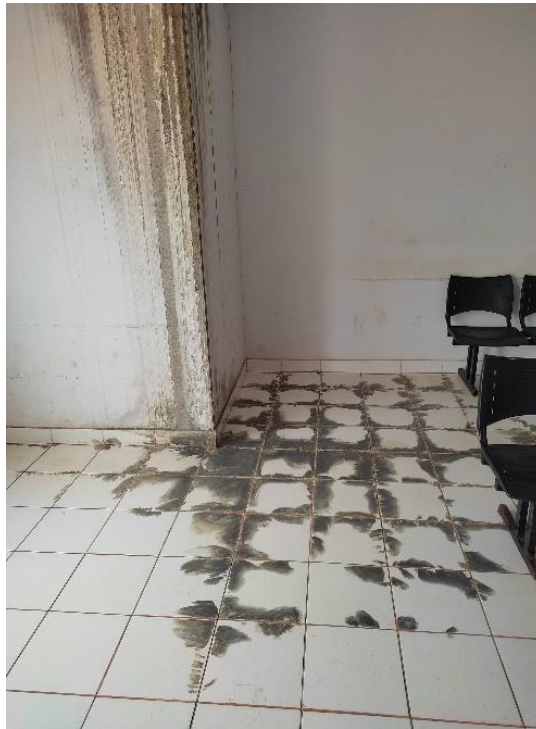
Figura 8 - Infiltração e manchas nas cerâmicas da unidade do Jardim Glória
