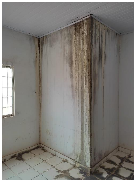
Figura 7 - Infiltração e manchas nas cerâmicas da unidade do Jardim Glória
