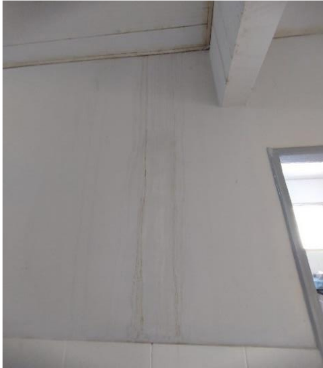
Figura 18 - Rastro de infiltração.
