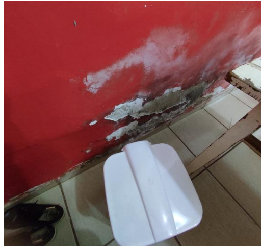
Figura 23 - Manchas de mofo; manchas e desprendimento do revestimento.
