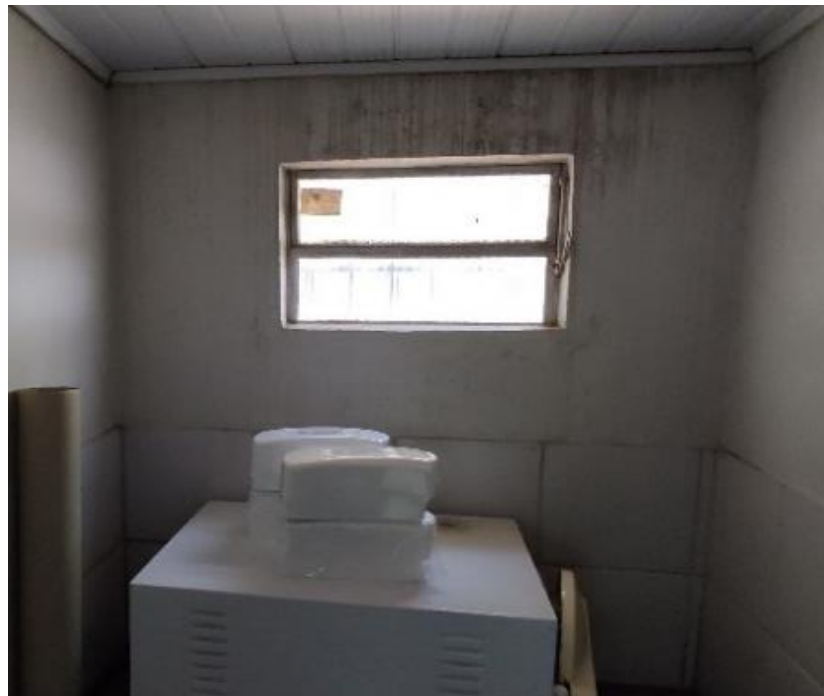
Figura 19 - Infiltração com manchas.
