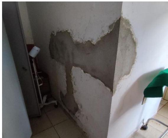
Figura 24 - Reparo devido infiltração.
