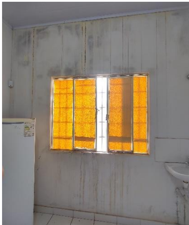
Figura 9 - Infiltração e manchas nas cerâmicas da unidade do Jardim Glória.
